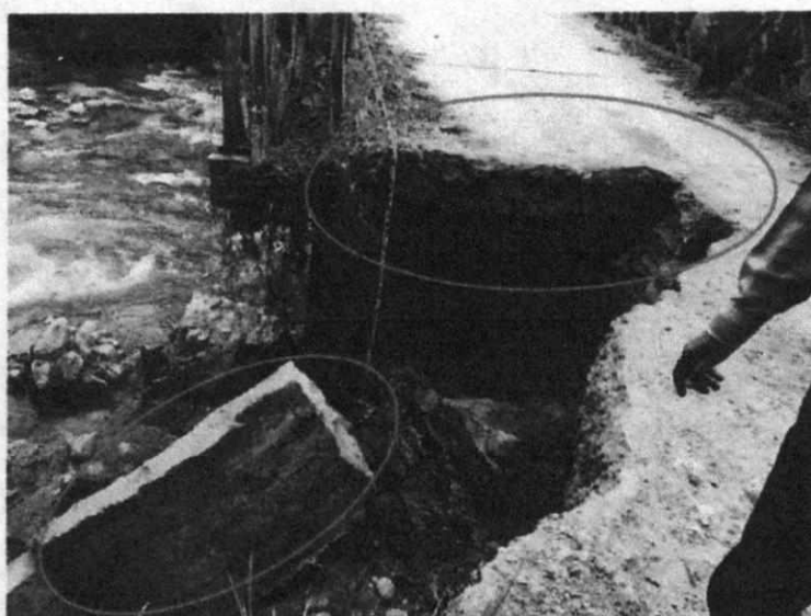
Foto 15. Viga del estribo caído y puente.
